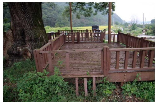
그림 3-77_무리하게 설치된 데크 근경(평상)
